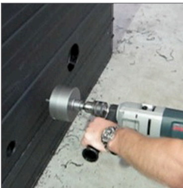
Flexible Rohranbindung vor Ort.
